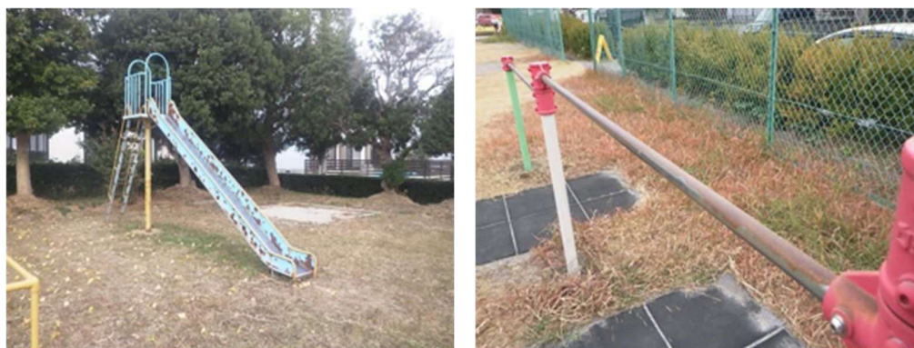
【老朽化した遊戯施設】
