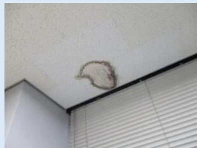
雨漏りがある執務スペース
