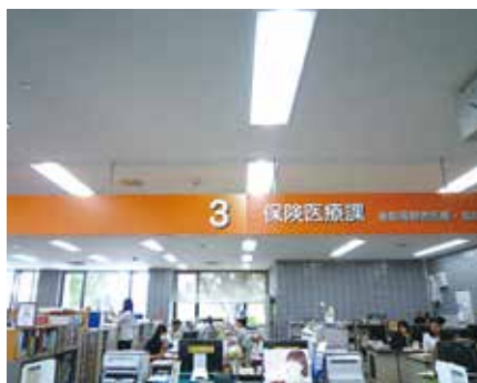
■役場本庁舎に設置されているLED照明
